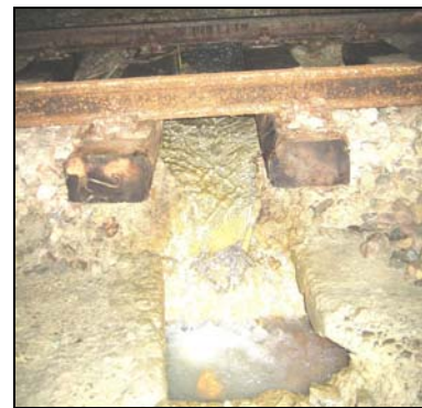
Versinterte Rinnenableitung in Mittelkanal
